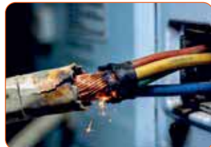
● 电线老化, 破损导致短路产生电弧, 火花引起火灾
